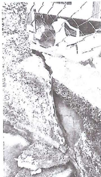
Destacamento da alvenaria do muro divisório.
